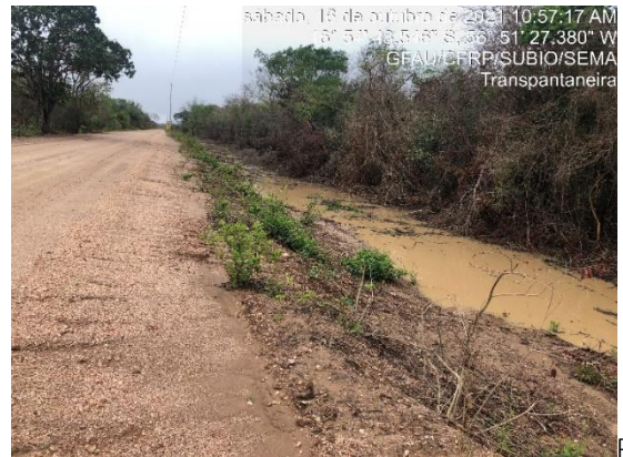
Pontos alagados a margem da estrada.
