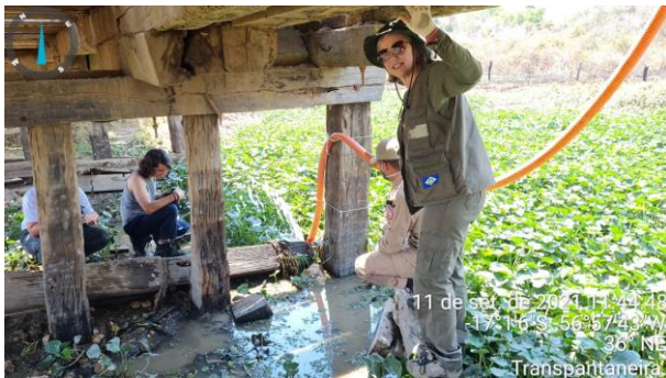
Foto 03: Abastecimento de água por caminhão pipa disponibilizado pela SEMA. Ponte 72.
